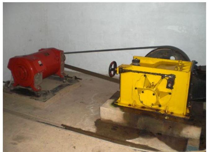
25kW speist der deutsche Generator ein
